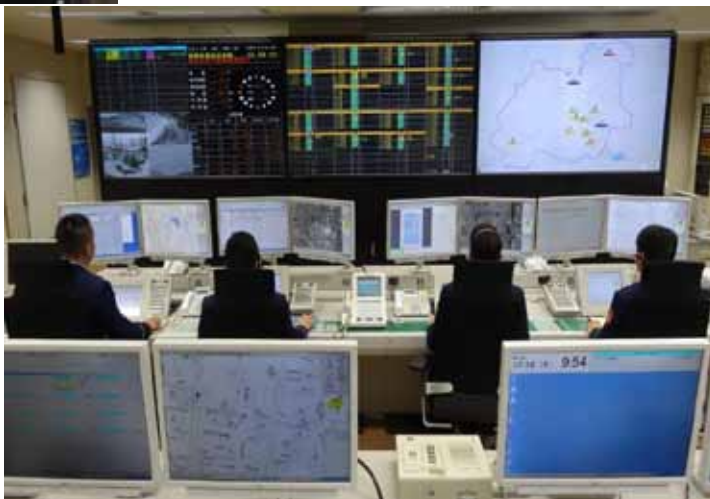
通信指令室内の様子
